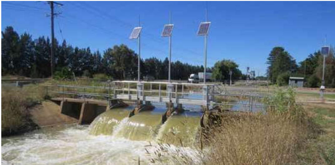
Sistema de control, medición y cobro por el uso de agua de riego en la MDB.
