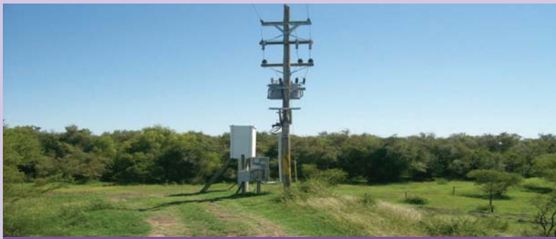
Subestación transformadora 15/0.4 KV para bombeo sobre el río Cuareim
